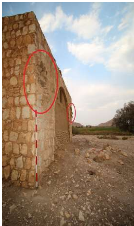
شکل ۱۲- بقایای داغی‌های قوس راهروی میانی در ضلع جنوب شرقی چهارطاقی رحمت‌آباد (نگارندگان)
